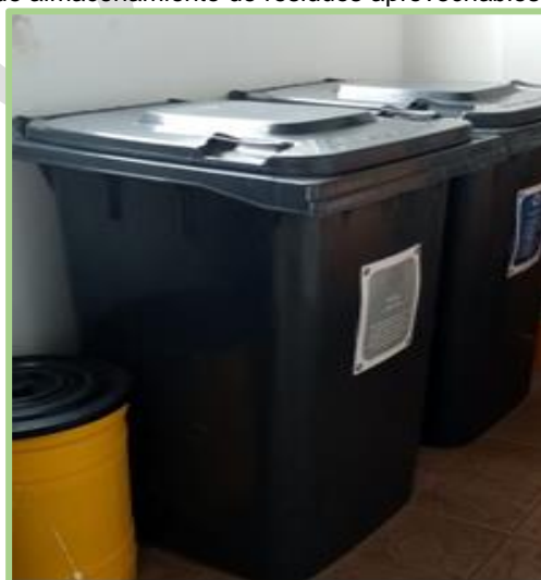
Ilustración 8. Cuarto de almacenamiento de residuos aprovechables Regional CZ Villanueva
