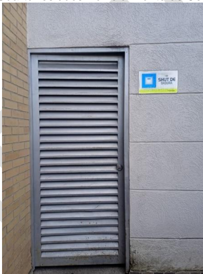
Ilustración 16. Cuarto residuos Edificio Fronteras Centro Zonal Jordán
