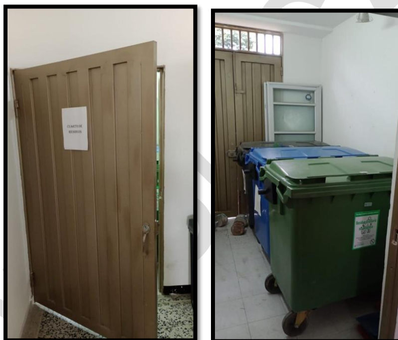
Ilustración 12. Cuarto de almacenamiento de residuos especiales y peligrosos centro zonal Pitalito
