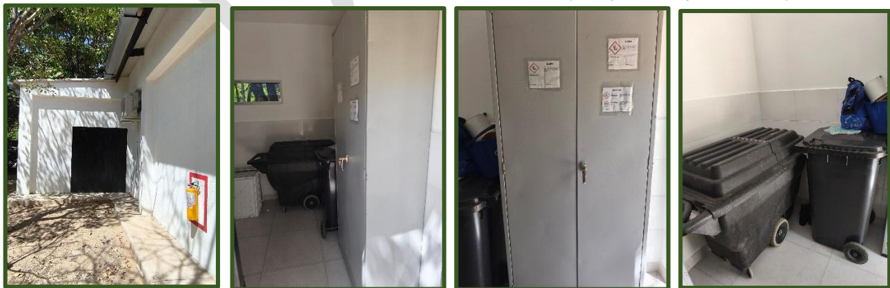
Ilustración 8. Cuarto de almacenamiento de residuos especiales y peligrosos Regional La Guajira
