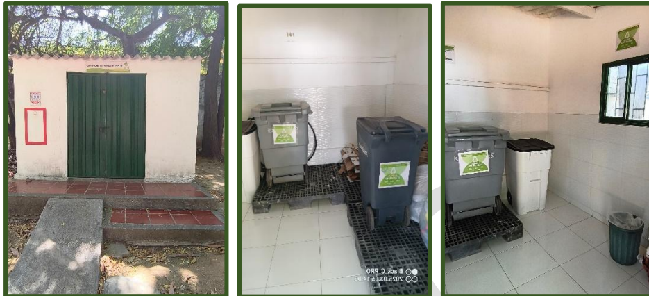
Ilustración 7. Cuarto de almacenamiento de residuos aprovechables Regional La Guajira
