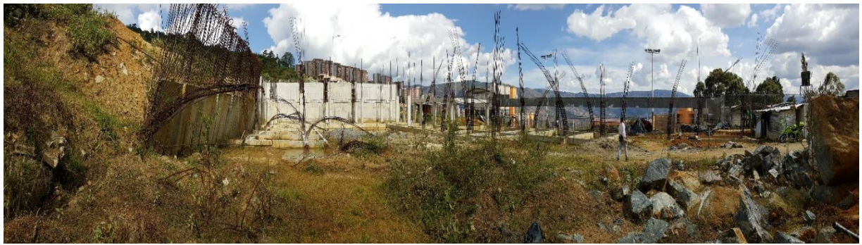
Imagen 1. Vista general del predio. Se observa el talud afectado por el proceso de remoción en masa y la obra (actualmente detenida)
