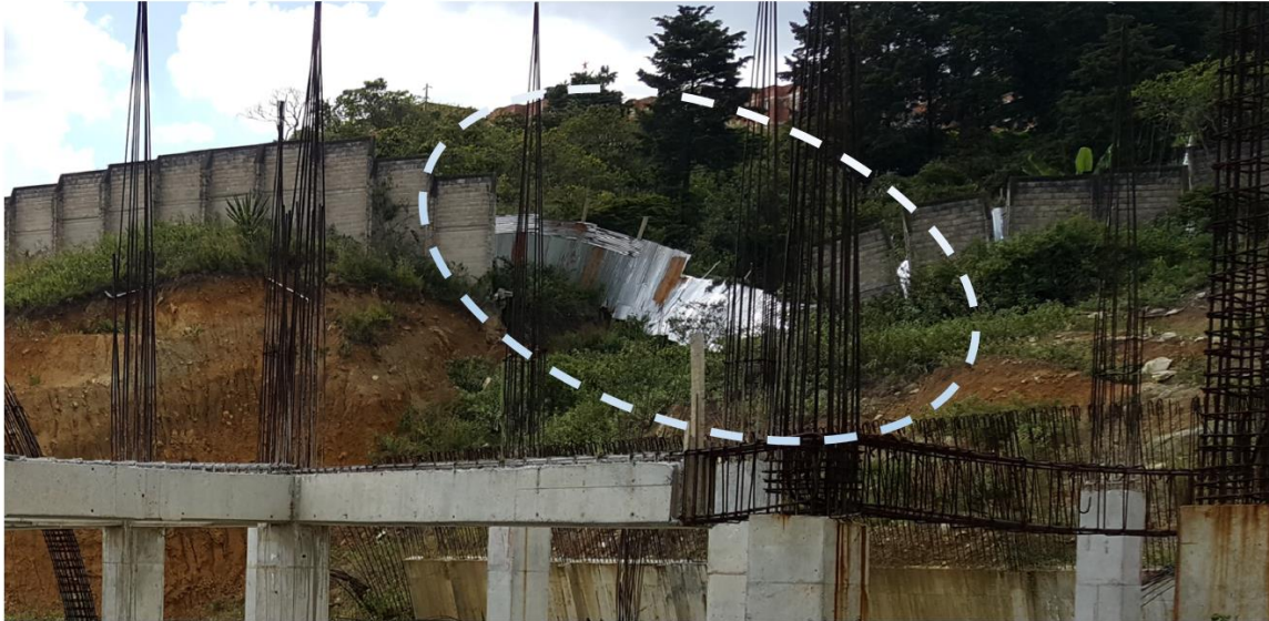
Vista del cerramiento de seguridad localizado en la superior del predio, que se encuentra colapsado en uno de sus tramos por efecto del deslizamiento.
